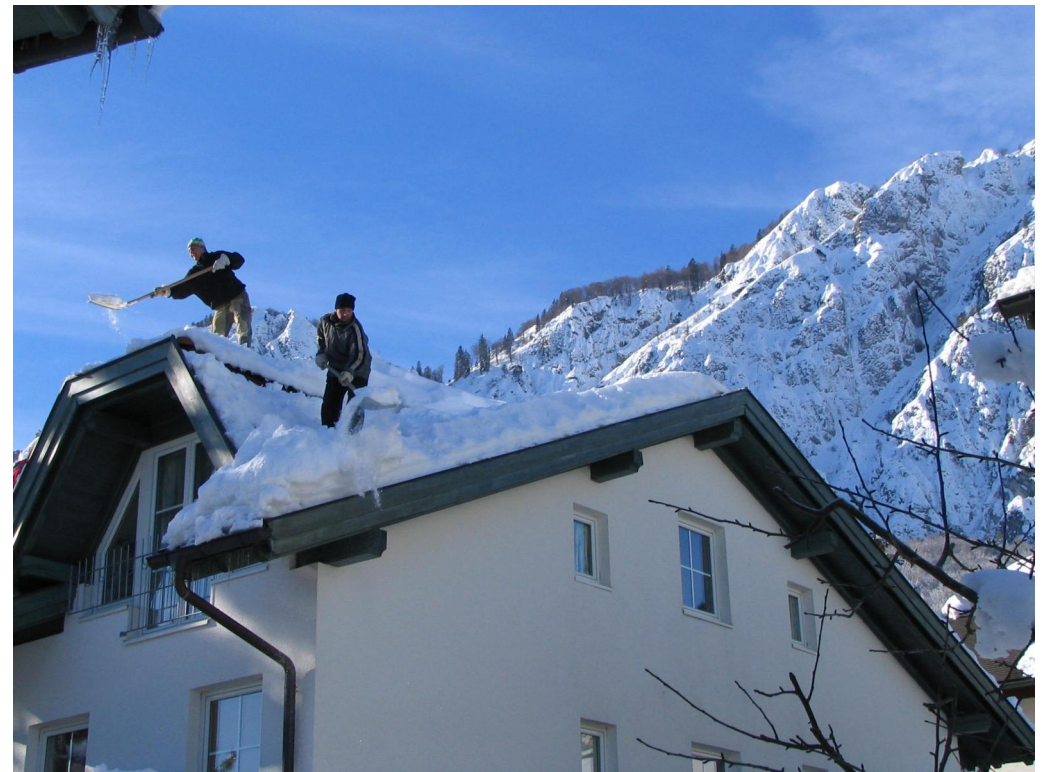
Jänner 2006, Schnee schaufeln am Dach ist eine sehr gefährliche Tätigkeit. Wochen zuvor am 1. Jänner 2006 stürzte die Eislaufhalle in Bad Reichenhall unter der Schneelast ein.
